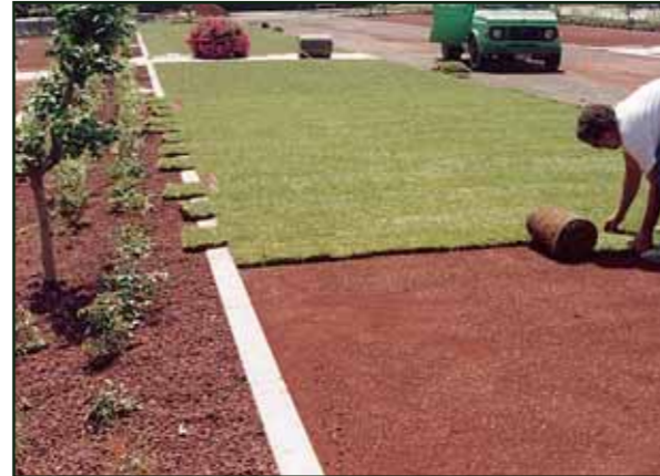
Fourniture et mise en place de rouleaux de gazon sur le terrain préparé avec une granulométrie de 0 à 12 mm.
