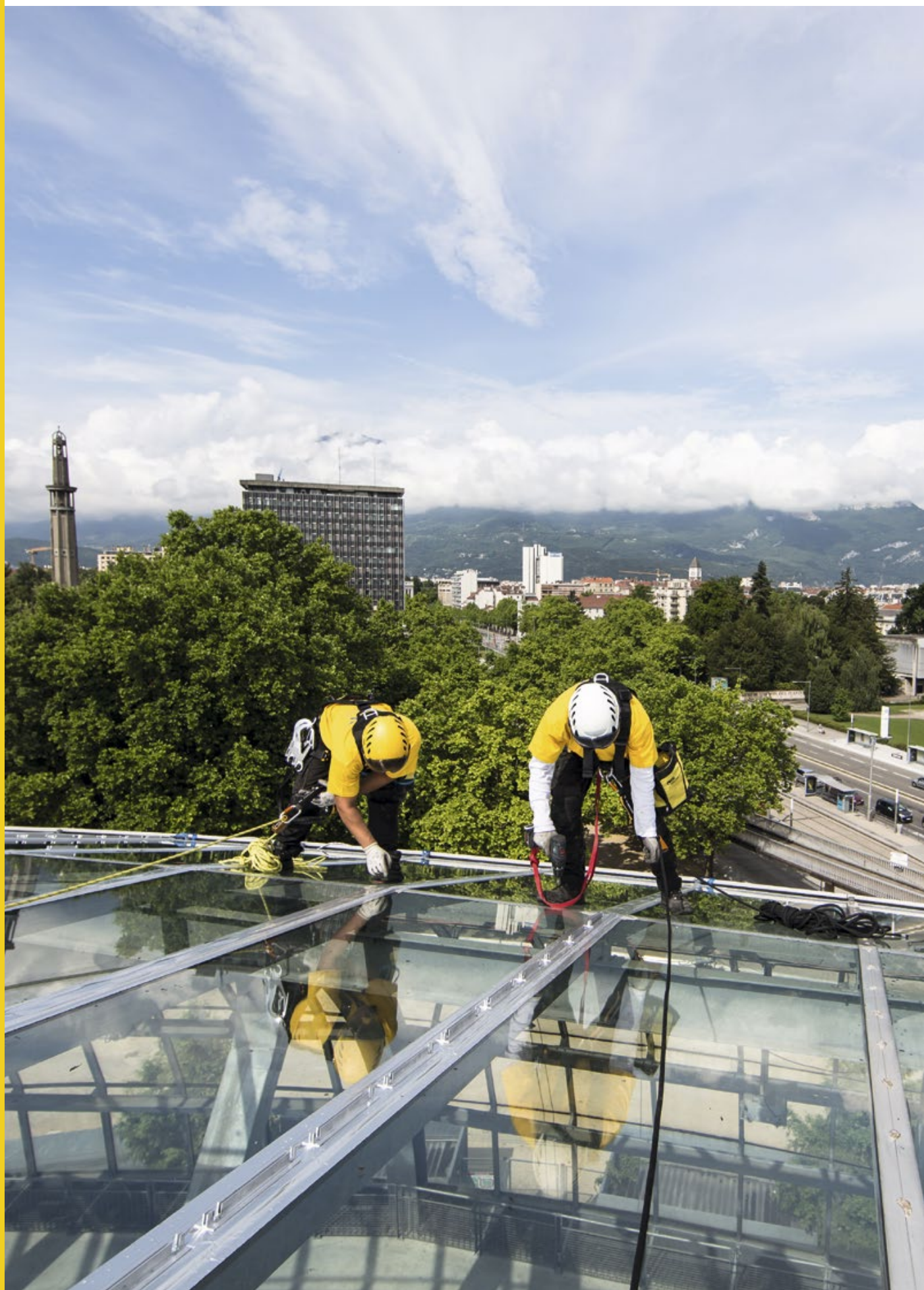
Glass panel roofing on the Stade des Alpes, Grenoble, Isère, France. © Petzl / Lafouche / Stade des Alpes / Acrosite / Barsalou
